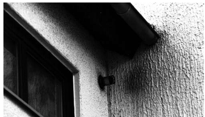
Uitmondung onder dakgoot → recirculatie → roetsporen op de muur
